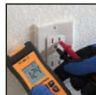
Tests GFCI** protected circuits (61-557)
